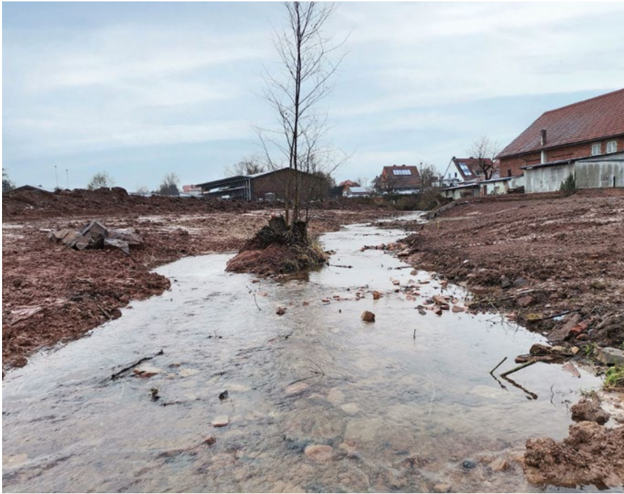
Abb. 4: Die Schweinfe-Baustelle im Winter 2021/22. Der Uferverbau wurde bereits entfernt; durch die Gewässeraufweitung wird die Breite um etwa das Dreifache gesteigert. (Foto: P. Mertke)
