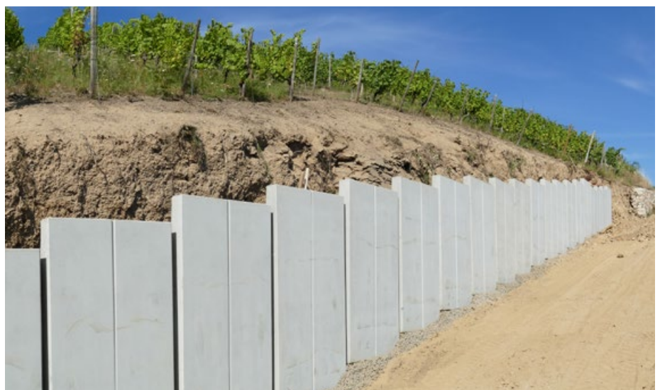
Abb. 2: Eltville-Martinsthal: Hangsicherung durch Errichtung von Stützwinkeln vor Trockenmaueraufbau im Sanierungsbereich (Foto: LPV Rheingau-Taunus)
